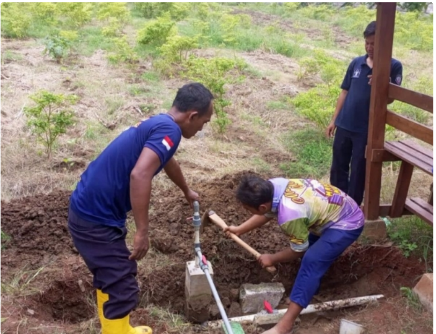
Rutin Rawat Pompa Air, Lapas Terbuka Kendal Jamin Ketersediaan Air Bersih
